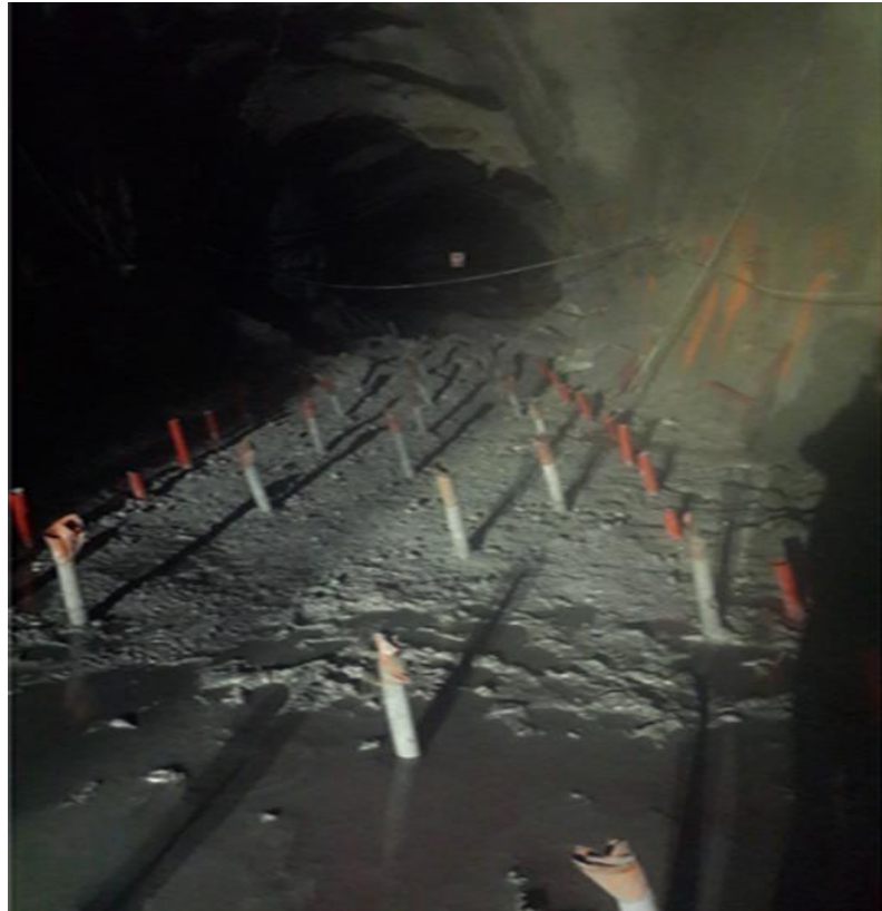
Ilustración 18. Carguío de Taladros con Tubería PVC
