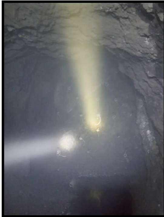
SN-140, Frente cargado sin sostenimiento y con chispeo directo.
