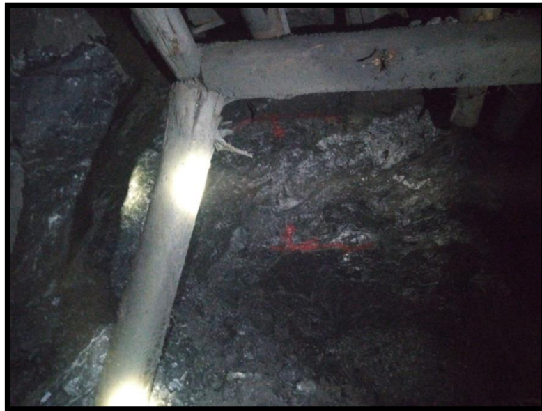
Cuadro de madera afectado por disparo.
