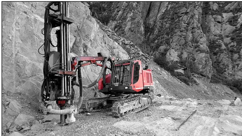
Figura 06. Equipo de perforación DX800.
