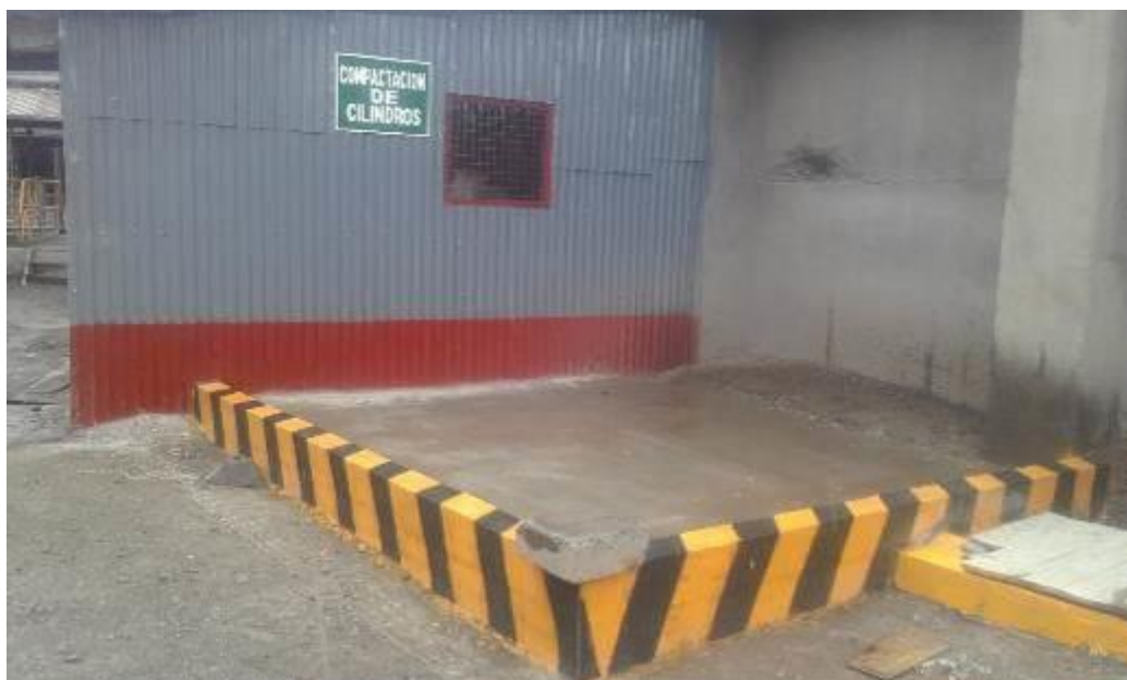
Vista de la plataforma para la compactación de cilindros de cianuro vacíos .
