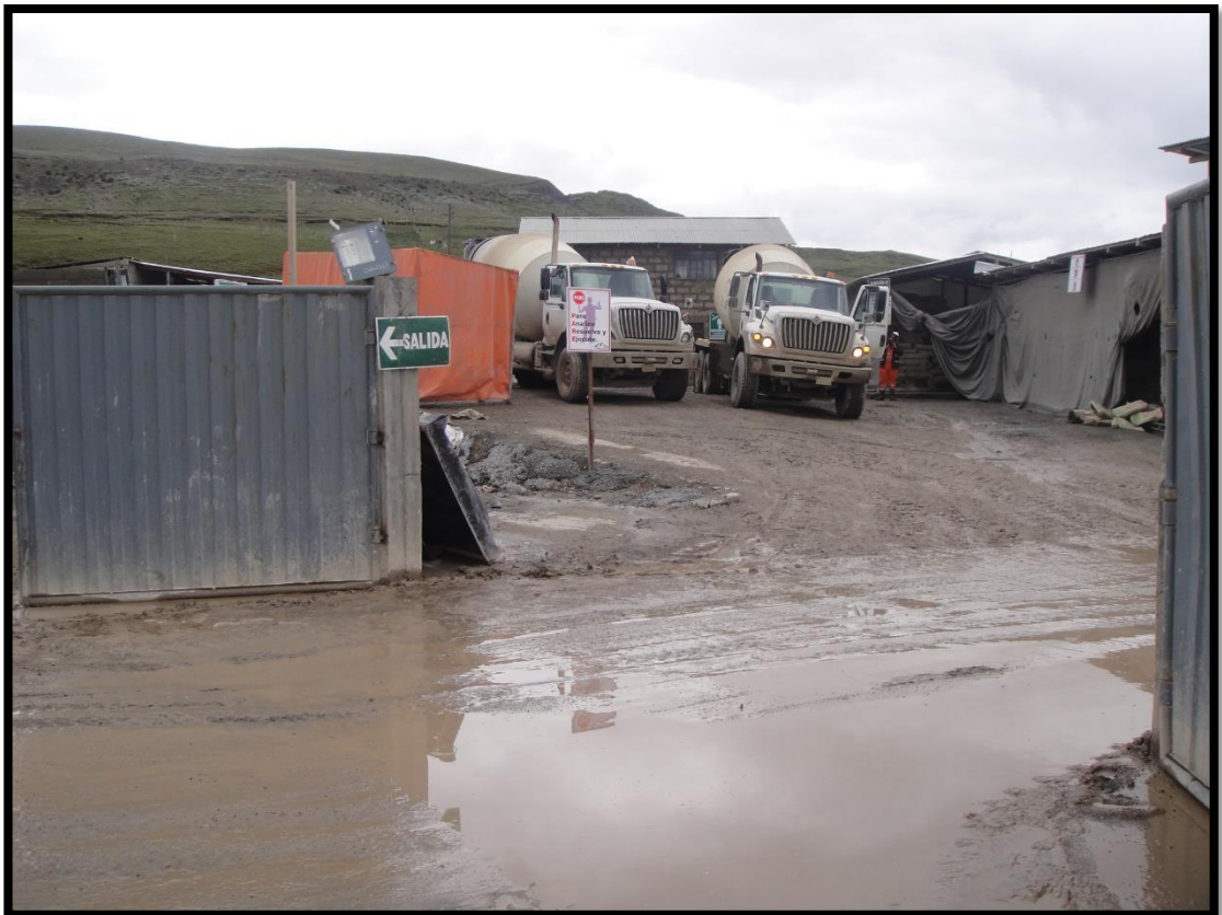
Foto N°02: Planta Concretera en Rancas
