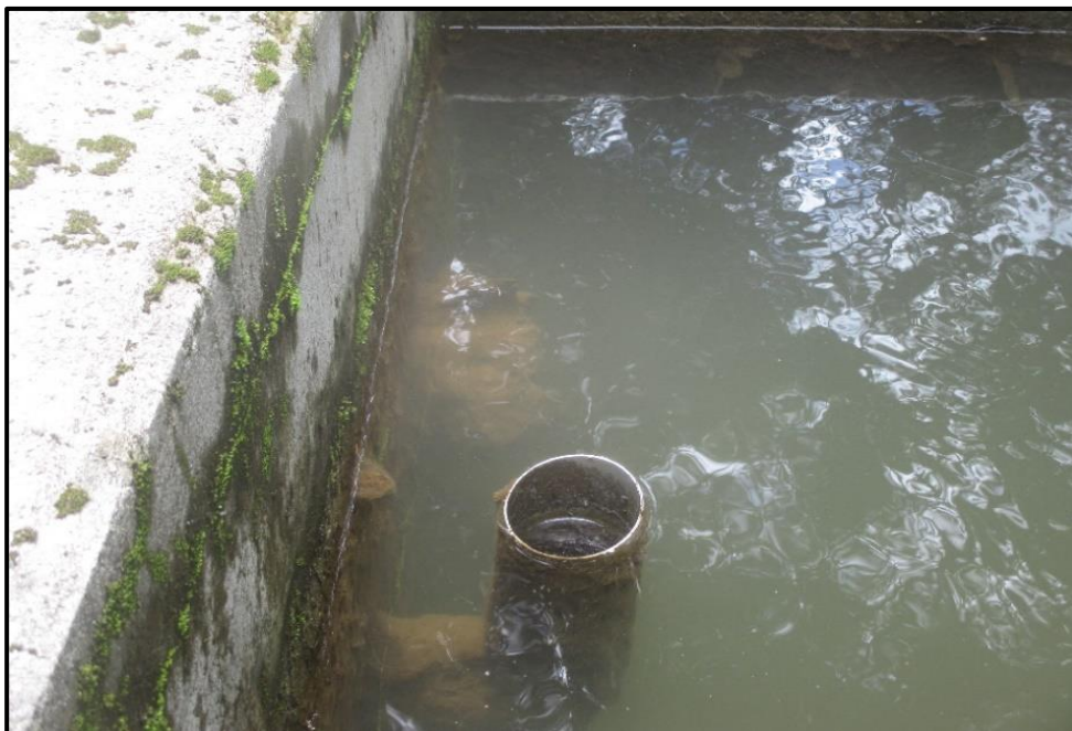
Fotografía N° 55: Estado de la infraestructura de captación Miraflores
