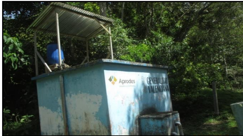
Fotografía N° 1: Estado del reservorio de agua de la CC.NN de Tsachopen (San Roque)
