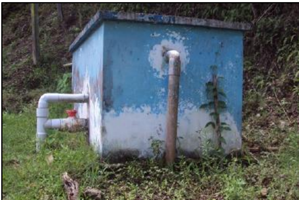
Fotografía N° 11: Reservorio de agua Miraflores
