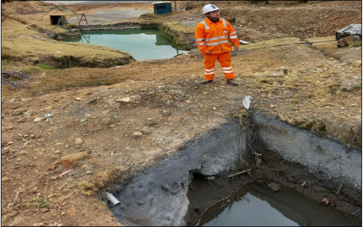
Ilustración 5: Poza de Sedimentación de salida de Agua de la Planta Metalúrgica San Sebastián AMC.
