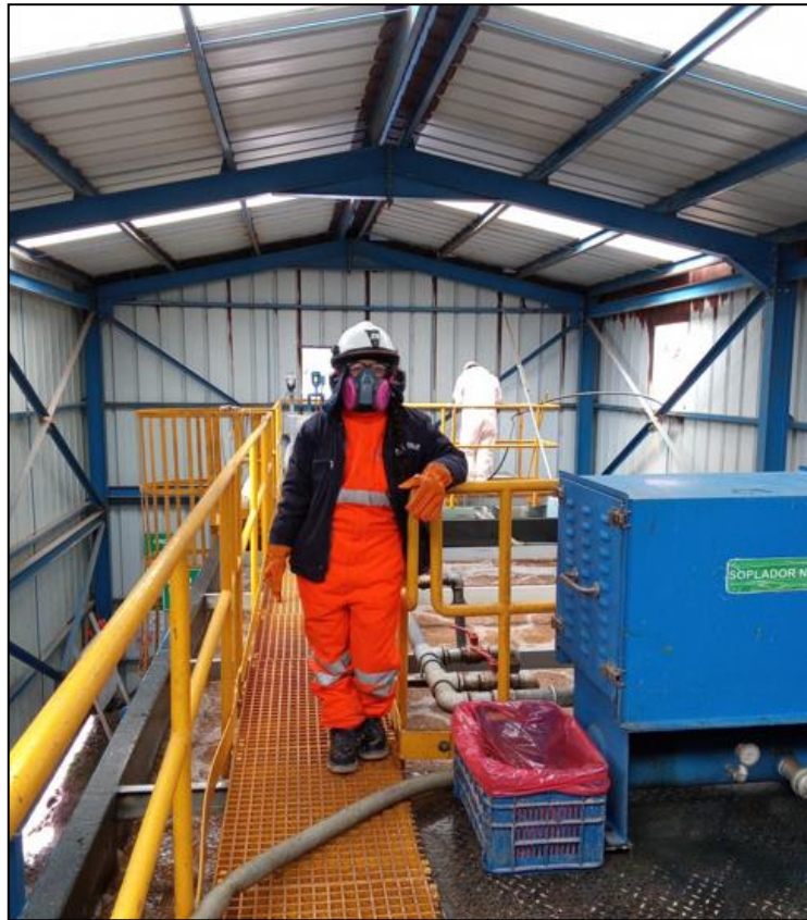
Imagen 009: Monitoreo a la Planta de Tratamiento de Aguas Domésticas
