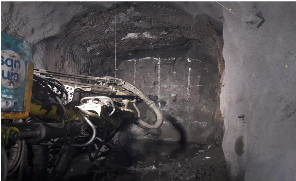
Nv. 4152 – Ga 636N por Ga Principal 8950W, Se observa la práctica de metro avanzado, metro sostenido con perno Split Set + Malla electrosoldada.
