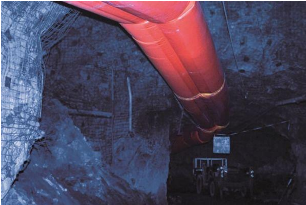
Figura 21. Manga de ventilación
