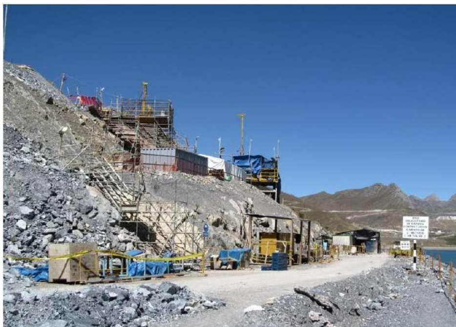
Figura 27. Vista de perfil mostrando la pendiente de la ladera y el camino de acceso a la base del plinto
