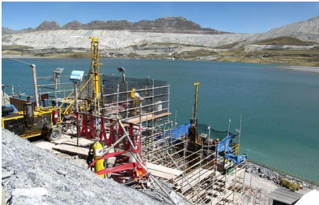
Figura 18. Plataformas vistas desde la parte superior del plinto derecho
