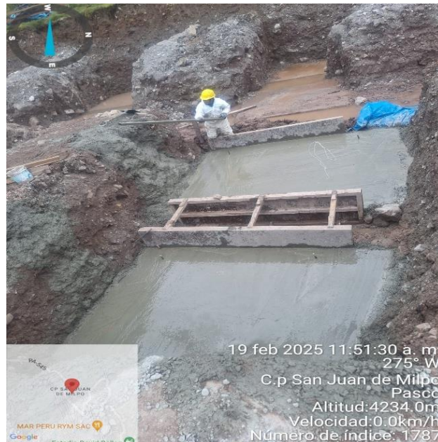
Figura 16. Paralización de trabajos en cimentaciones debido a la saturación del terreno por efecto de las lluvias
