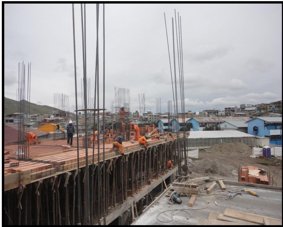
Fotografía N° 10: Un riesgo que se evidencio fue que la obra no cuenta con un sistema de seguridad para los trabajos en altura .
