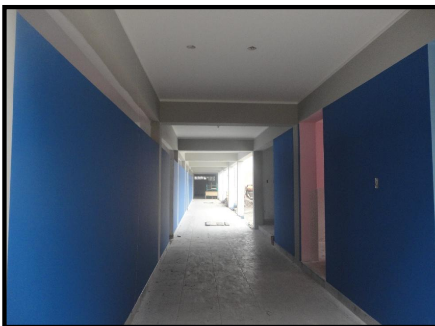
Fotografía N° 12: Entre los riesgos que aquejan fue la incompatibilidad de los planos de distintas especialidades.
