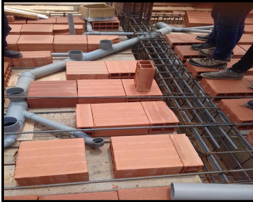
Fotografía N° 1: Interferencias en las especialidades de sanitarias y estructuras.
