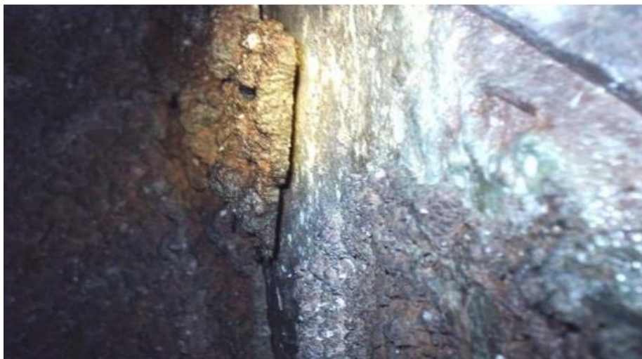
Figura 22: Falta de Adherencia del Shotcrete.
