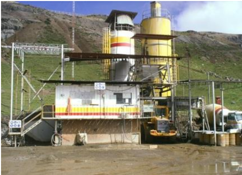
Figura 34: Planta de Concreto, para la preparación de mezcla Vía Seca y Húmeda.
