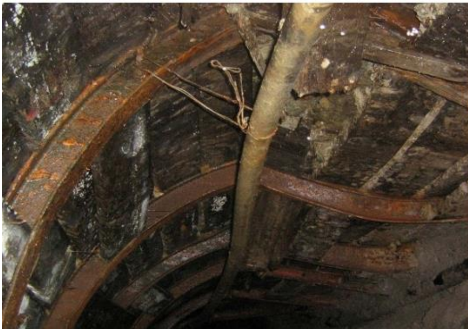
Figura 48: Efecto de Arqueo en la Cimbras Metálicas.
