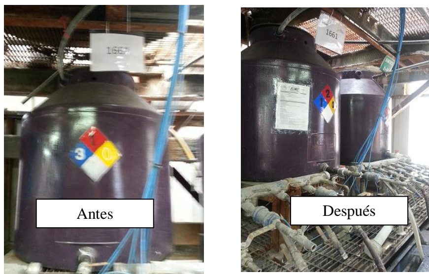
Figura N° 3.13: identificación de tanques
