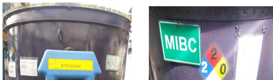
Figura N° 3.12: Tanque de MIBC
