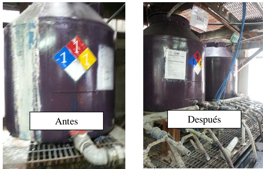
Figura 3.11: Tanques de dosificación de reactivos
