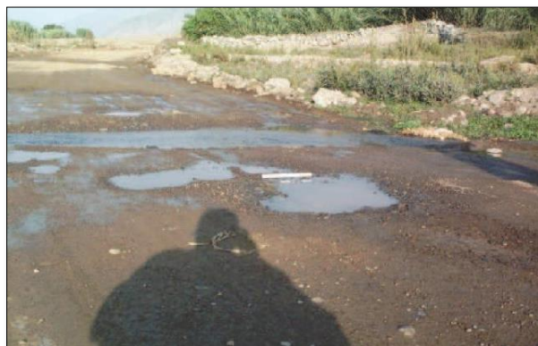
Imagen 10. Gravedad 3: Necesita una reconstrucción Fuente: MTC
