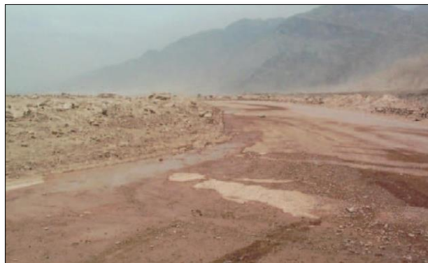
Imagen 9. Gravedad 2: Necesita una capa de material adicional Fuente: MTC
