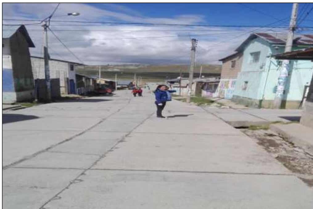
Imágenes N° 01: Vista de calles sin sistema pluvial
