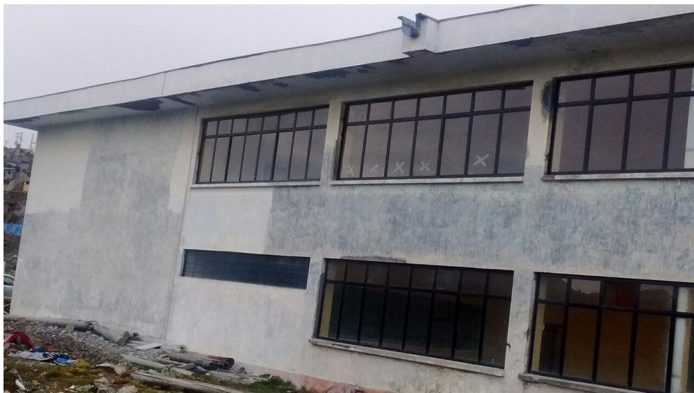
Incremento de concreto en tarrajes que aumentan el peso de la estructura.
