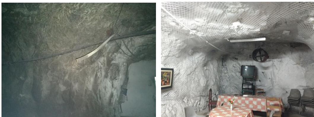
Imagen N° 04; Venturi instalado, sin instalación de aire comprimido
