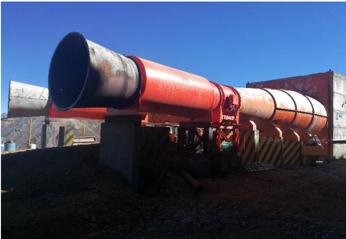
Foto N° 05, 06: Troncal IV, Ventilador VT-100-09 de 100,000 cfm con Silenciador instalado.
