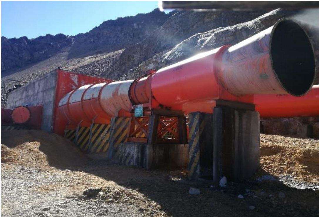
Foto N° 07, 08: Troncal IV, Ventilador VT-100-01 de 100,000 cfm con Silenciador instalado.
