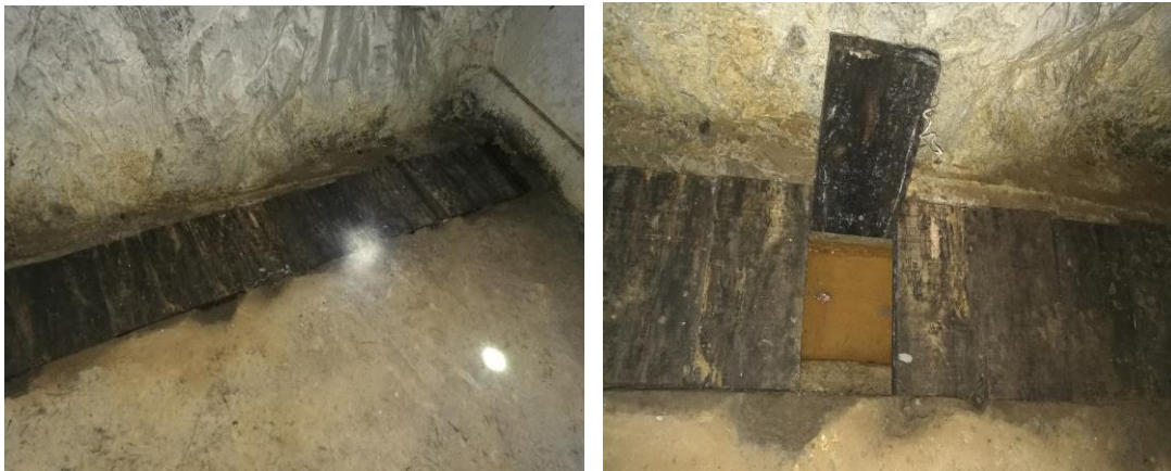
Imagen N° 03; Cuneta cubierta con madera en estado de descomposición
