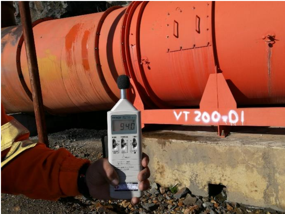
Foto N° 13, 14, 15: Medición de Nivel de ruido en los Ventiladores principales: Troncal IV, RB 9, San Juan. Antes de la instalación de los silenciadores.
