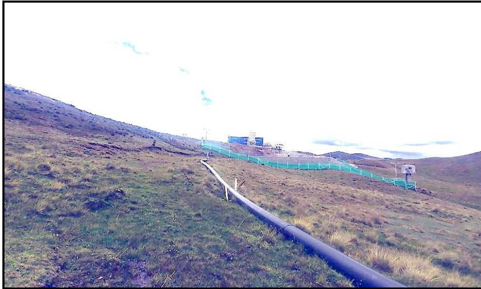
Imagen N°14: Tubería sin medida de Contingencia
