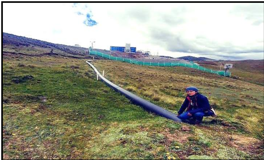
Imagen N°5: Línea de Conducción de Relave
