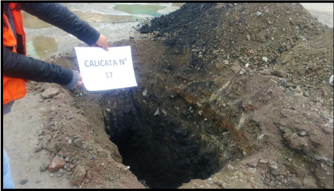
Foto 11. Se encontró relleno sanitario en la calicata 17.
