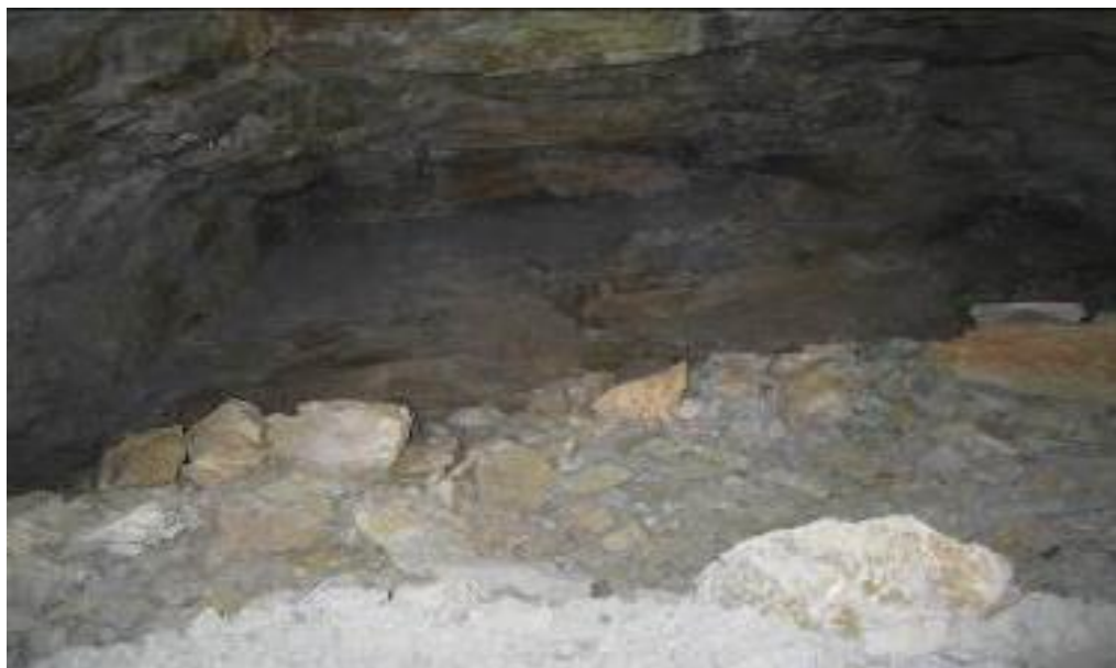
Imagen N° 4.6: Frente fracturas del Túnel Victoria
