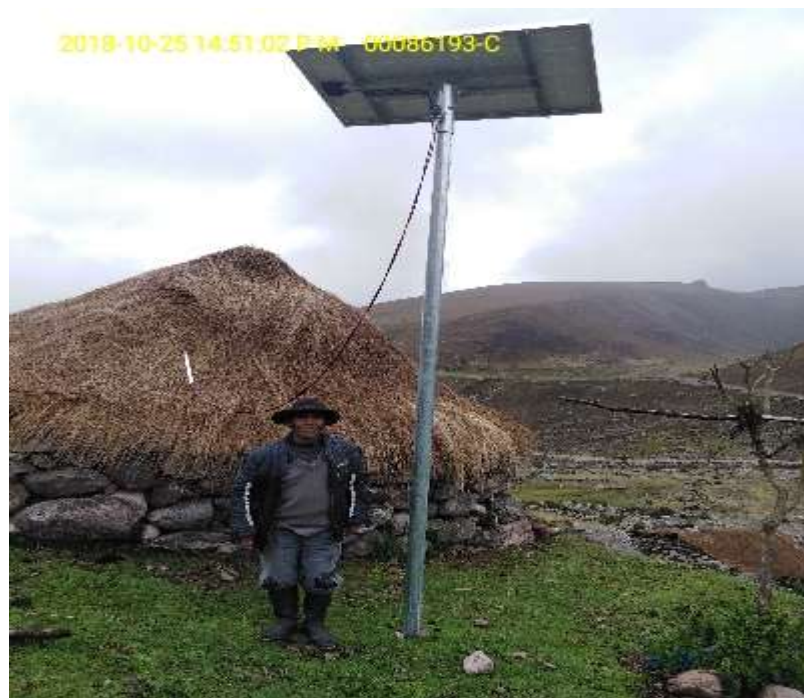
Fotografía N° 08: vista panorámica de los paneles fotovoltaicos instaladas en la comunidad de Puru Puru
