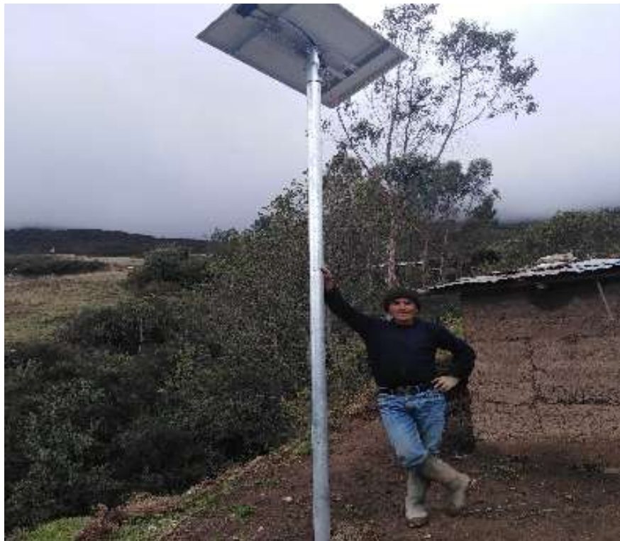
Fotografía N° 02: vista panorámica de los paneles fotovoltaicos instaladas en la comunidad de Quisuar
