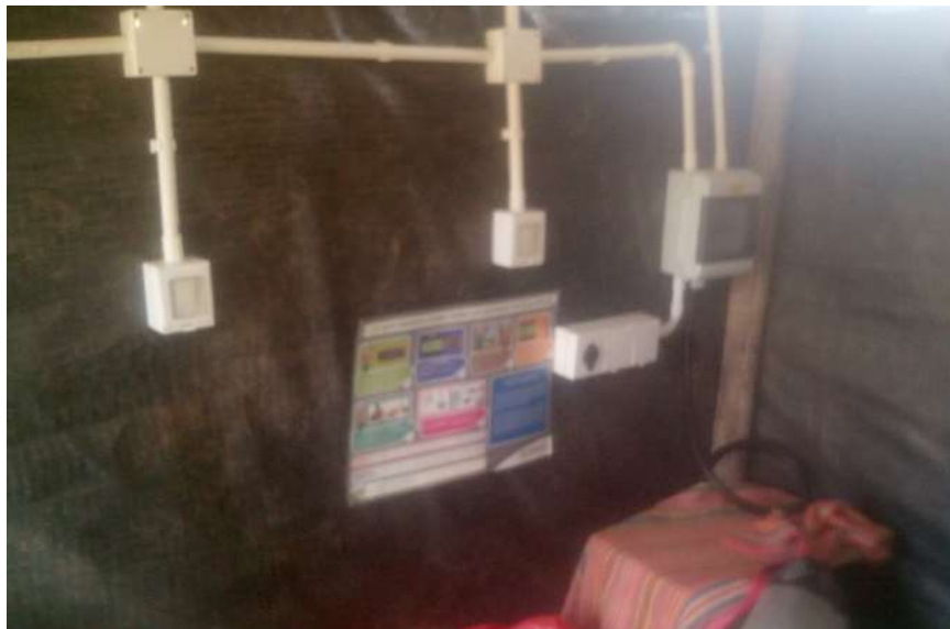
Fotografía N° 04: vista panorámica del sistema fotovoltaico del interior de una vivienda en la comunidad de Puru Puru.
